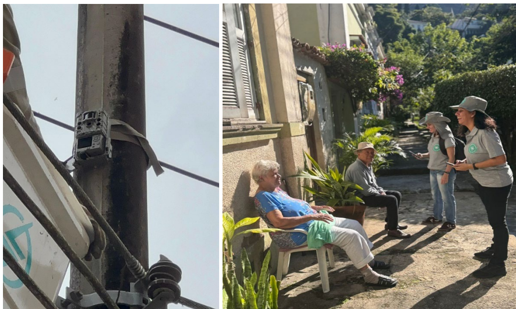
Figura 5. Atividades realizadas ao longo do projeto para o monitoramento da fauna impactada na rede elétrica. À esquerda, instalação de câmeras em poste de distribuição; à direita participação cidadã, através de entrevistas e engajamento de moradores.
